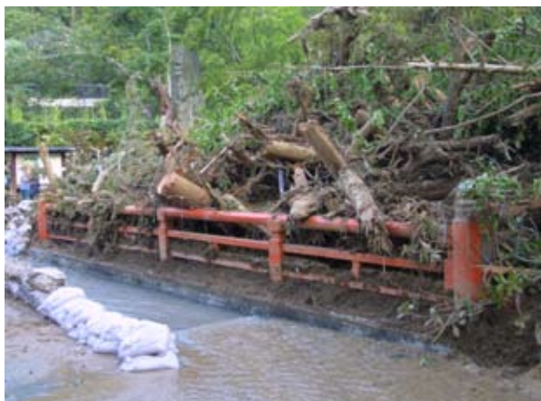
滝町の様子。滝橋上の土砂や流木を撤去した後の様子 (宮島白糸川下流, 2005年9月9日撮影)
